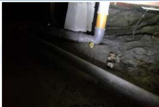
22 | Pvc buizen kruipruimte
