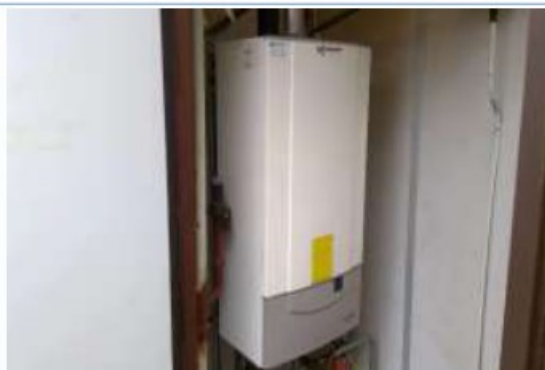
24 | Cv ketel bouwjaar 2010
